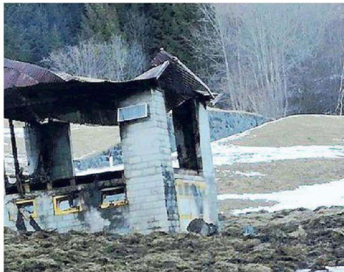
Uno stavolo danneggiato dalle fiamme lungo la strada per Pramollo
